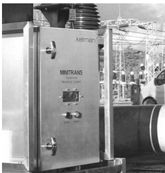
Рис. 2.22. Блок системы непрерывного анализа растворенных газов в масле трансформатора MINTRANS
