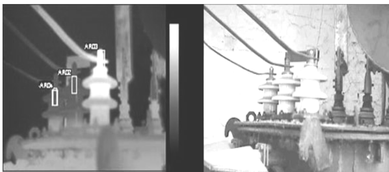
Рис. 2.12. Дефектный «правый» болтовой контакт шины и шпильки ввода трансформатора
