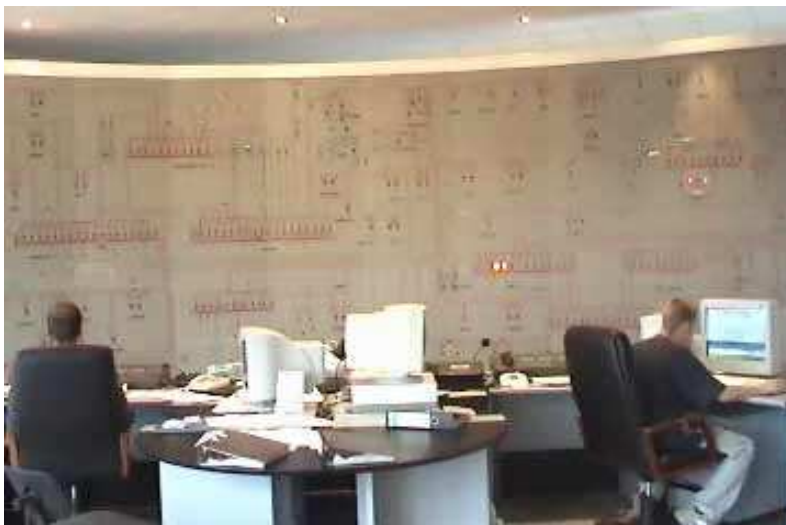
Рис. 1.2. Мнемонический щит энергетической системы
