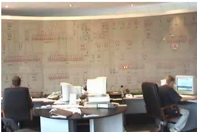
Рис. 4.2. Мнемонический щит энергетической системы
