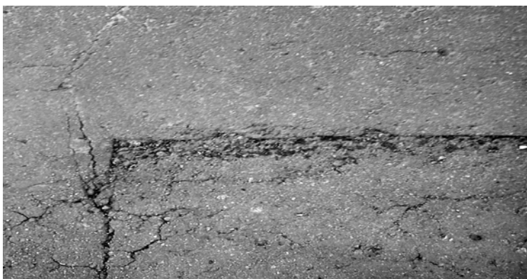
Рис. 3.6. Разрушение асфальтобетона в выбоине в зоне контакта с покрытием
