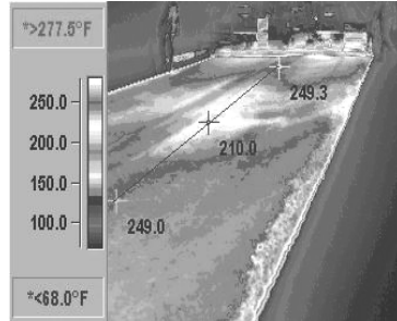
Рис. 4.13. Температурная сегрегация смеси при укладке
