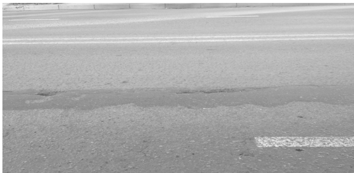
Рис. 5.55. Дефект дорожного покрытия на стыке двух полос
