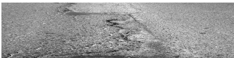
Рис. 3.7. Динамика развития разрушения покрытия в зоне стыка полос дорожного покрытия
