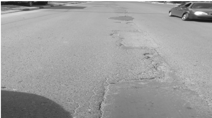
Рис. 1.4. Дефект дорожного покрытия на стыке двух полос
