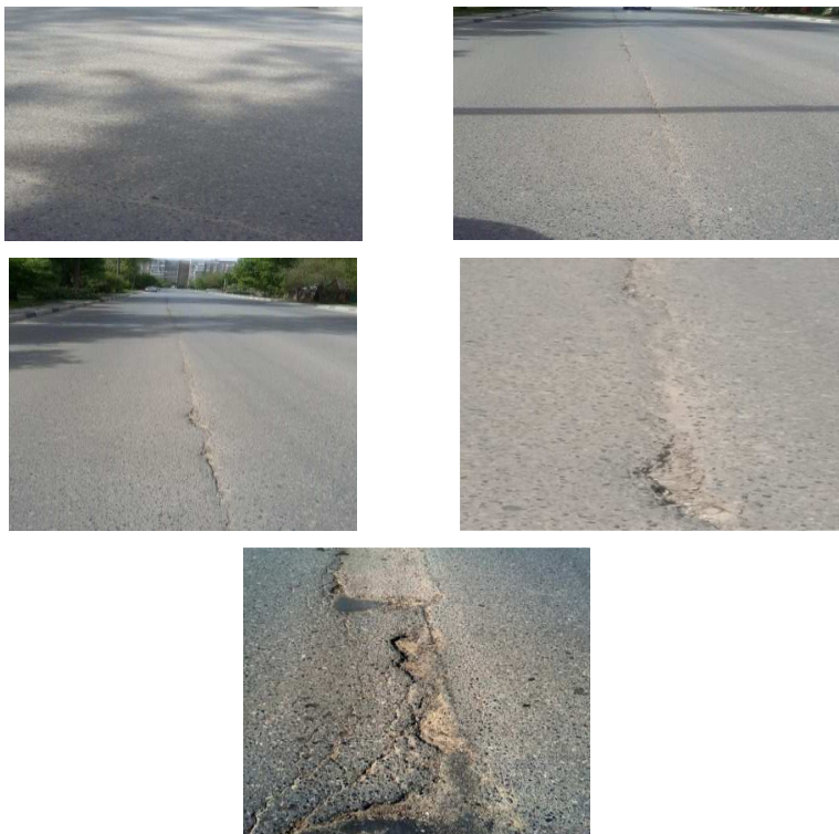
Рис. 5.11. Динамика развития разрушения покрытия в зоне стыка полос дорожного покрытия
