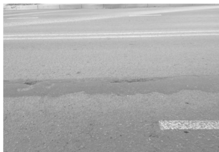
Рис. 6.38. Дефект дорожного покрытия на стыке двух полос
