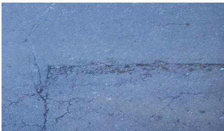
Рис. 9.10. Разрушение асфальтобетона в выбоине в зоне контакта с покрытием
