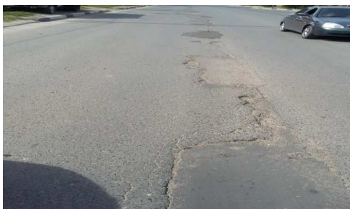
Рис 5.4. Дефект покрытия в зоне стыка сопряженных полос
