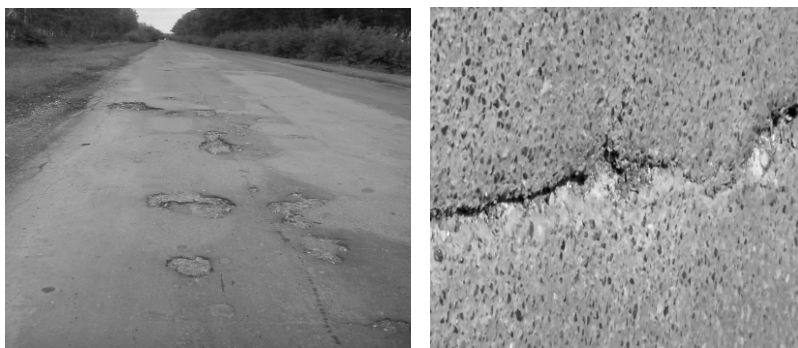
Рис. 1.1. Разрушение дорожного покрытия за счет недостаточного уплотнения основания и нарушения температурных режимов горячей смеси в зоне стыка сопряженных полос покрытия
