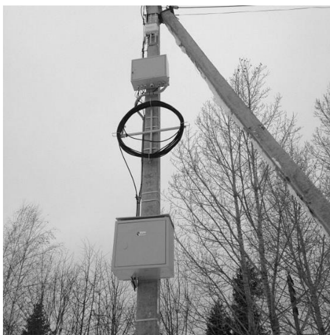
Рис. 1. Пример монтажа точки доступа по проекту «Устранение цифрового неравенства»
