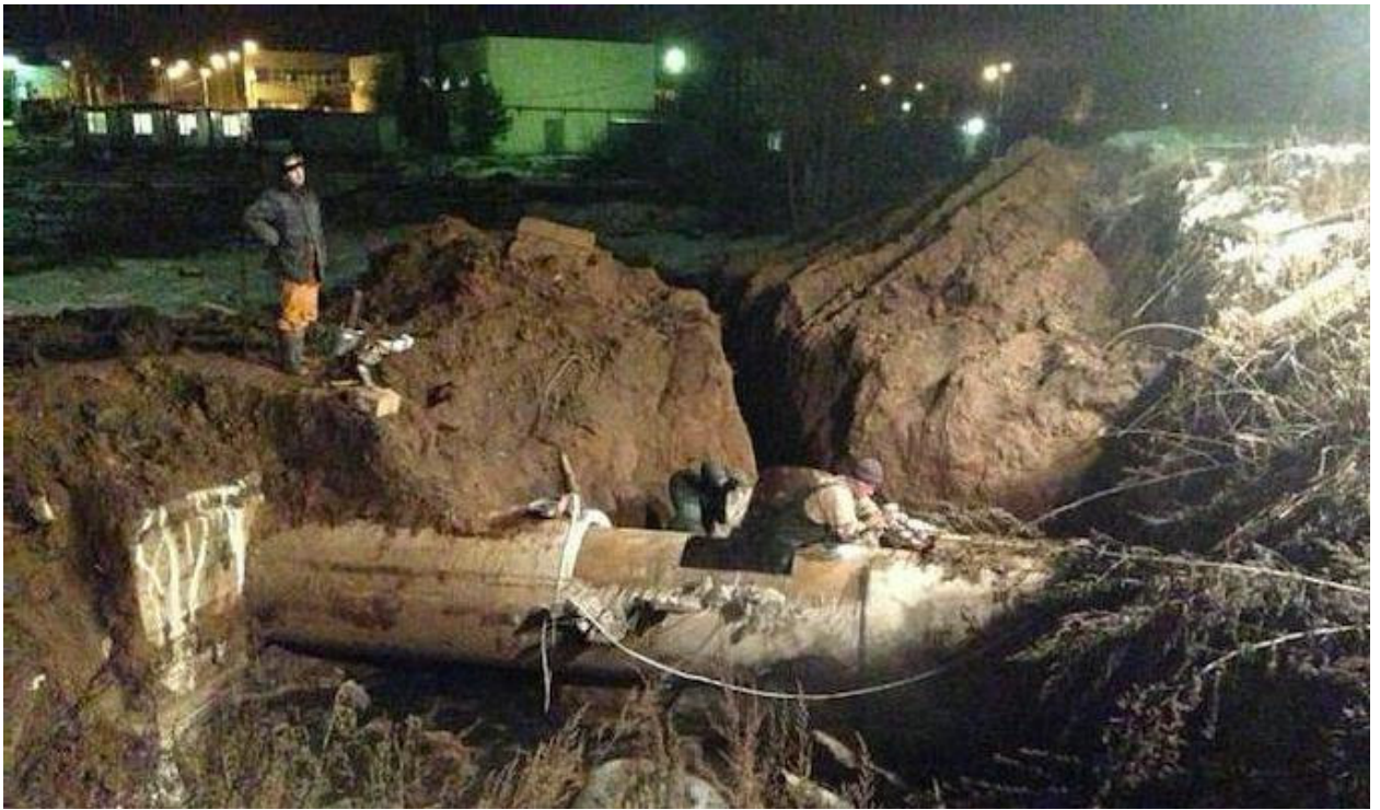
Аварии на очистных сооружениях
